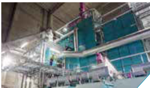
3兆瓦蒸汽热电联产电厂的燃料进料和脱灰系统细节图像
