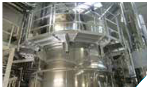
有机朗肯循环(ORC)热电联产电厂导热油换热器细节图像
