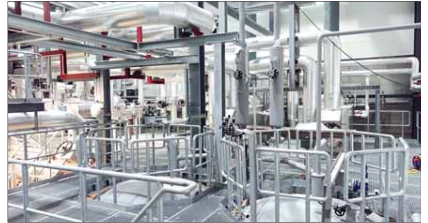
Blick von oben auf die Thermoölkessel und Verrohrung
