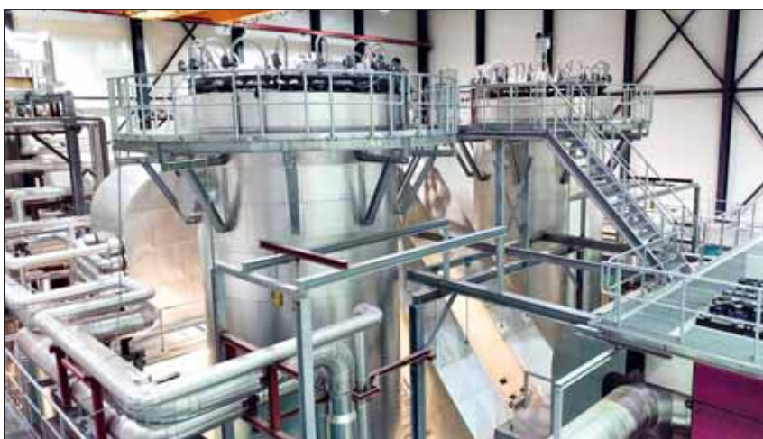
Wie in diesem Bild gut zu erkennen ist, besteht die Kesselanlage aus zwei parallel arbeitenden Feuerungs- und Kesselanlagen.
