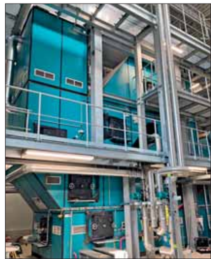
7 000-kW-Mittelstromfeuerungsanlage für die Fernwärme Eisenstadt
