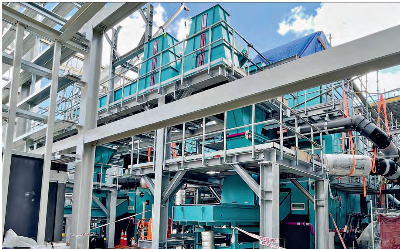
Sägewerksreste sollen auch bei einem Projekt in Christchurch verwertet werden: Das Heizwerk für ein 15,6-MW-Fernwärmenetz soll u. a. ein Krankenhaus mit Wärme versorgen. Es ersetzt ein Heizwerk, das auf Basis von Kohle betrieben wird.
