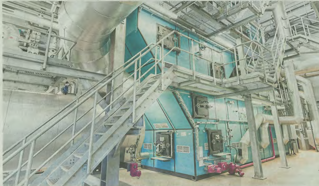
10.000 KW Polytechnik-Sattdampfkesselanlage mit hydraulischer Vorschubrostfeuerung
